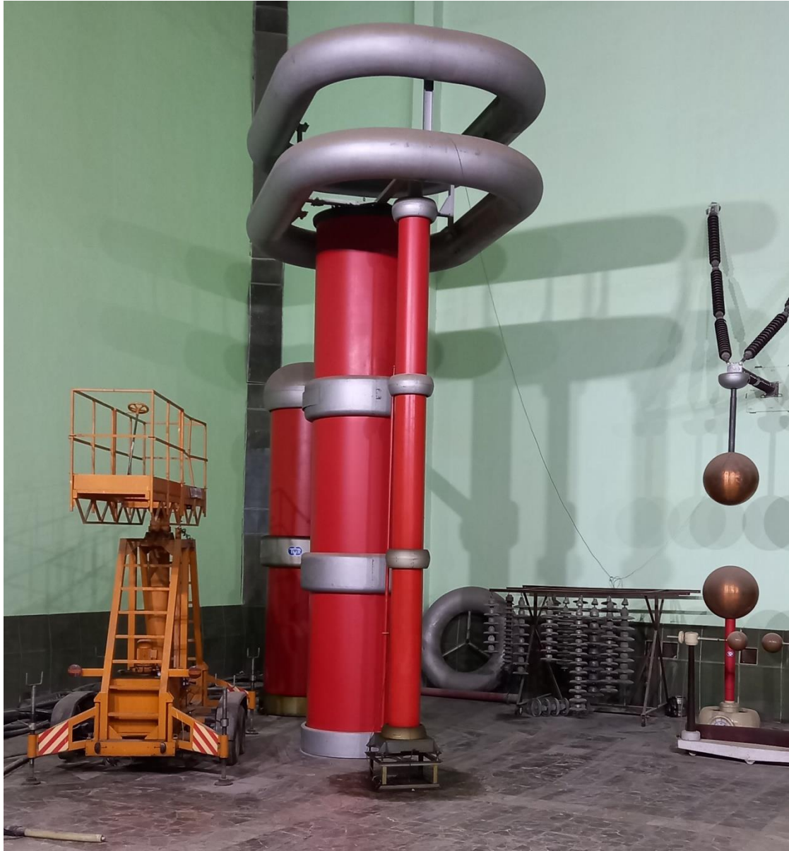
مولد توتر عالي متناوب ثلاث مراحل بخرج 1000kv
