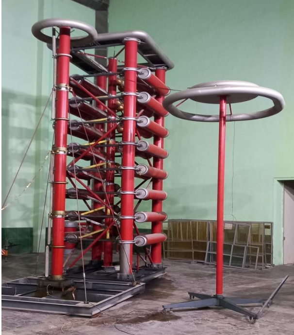
مولد توتر عالي نبضي ثمان مراحل بخرج 2400kv
